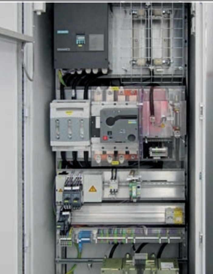
Eifel-Kraftwerk Olef – Statische Erregung auf Sinamics-Basis.
