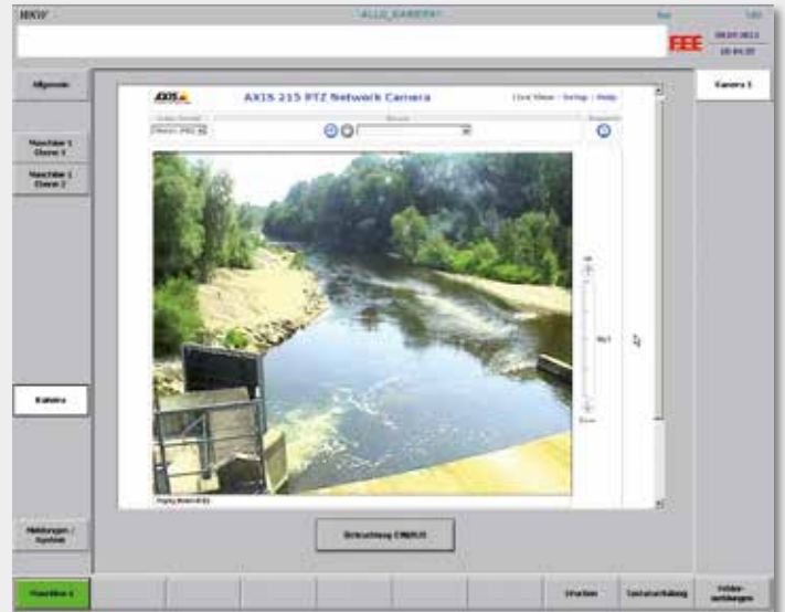
Abb. 9: Videoüberwachung des Unterwassers eines Wasserkraftwerks
